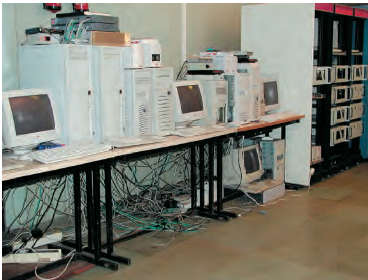
Оборудование сети Механико- математического факультета МГУ.
